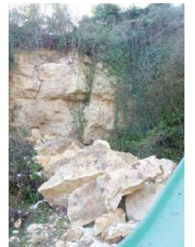
Effondrement, Villennes sur Seine
