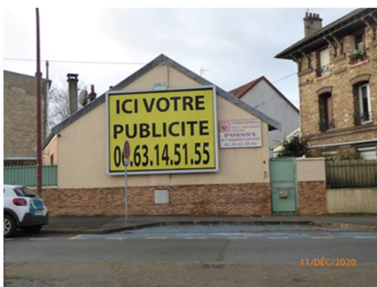
Dépasse les limites de l'égout du toit
